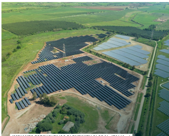
IMPIANTO FOTOVOLTAICO DI ENFINITY GLOBAL, ITALIA - 1
